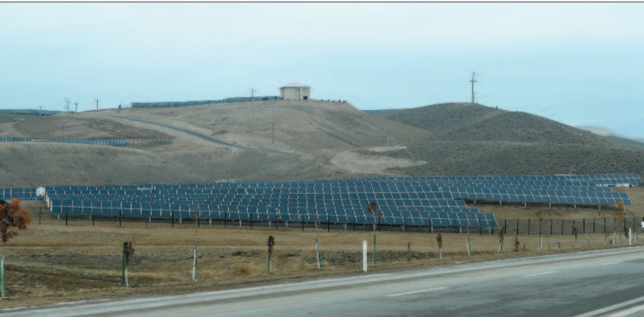
20 mVt gücündə Naxçıvan Günəş Elektrik Stansiyası
